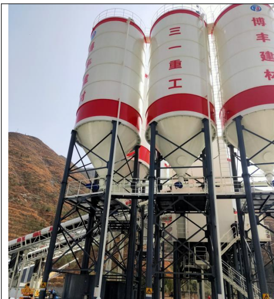
粉料储罐及搅拌楼
