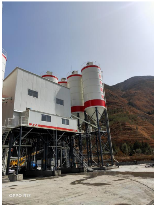
筒仓自带除尘器
